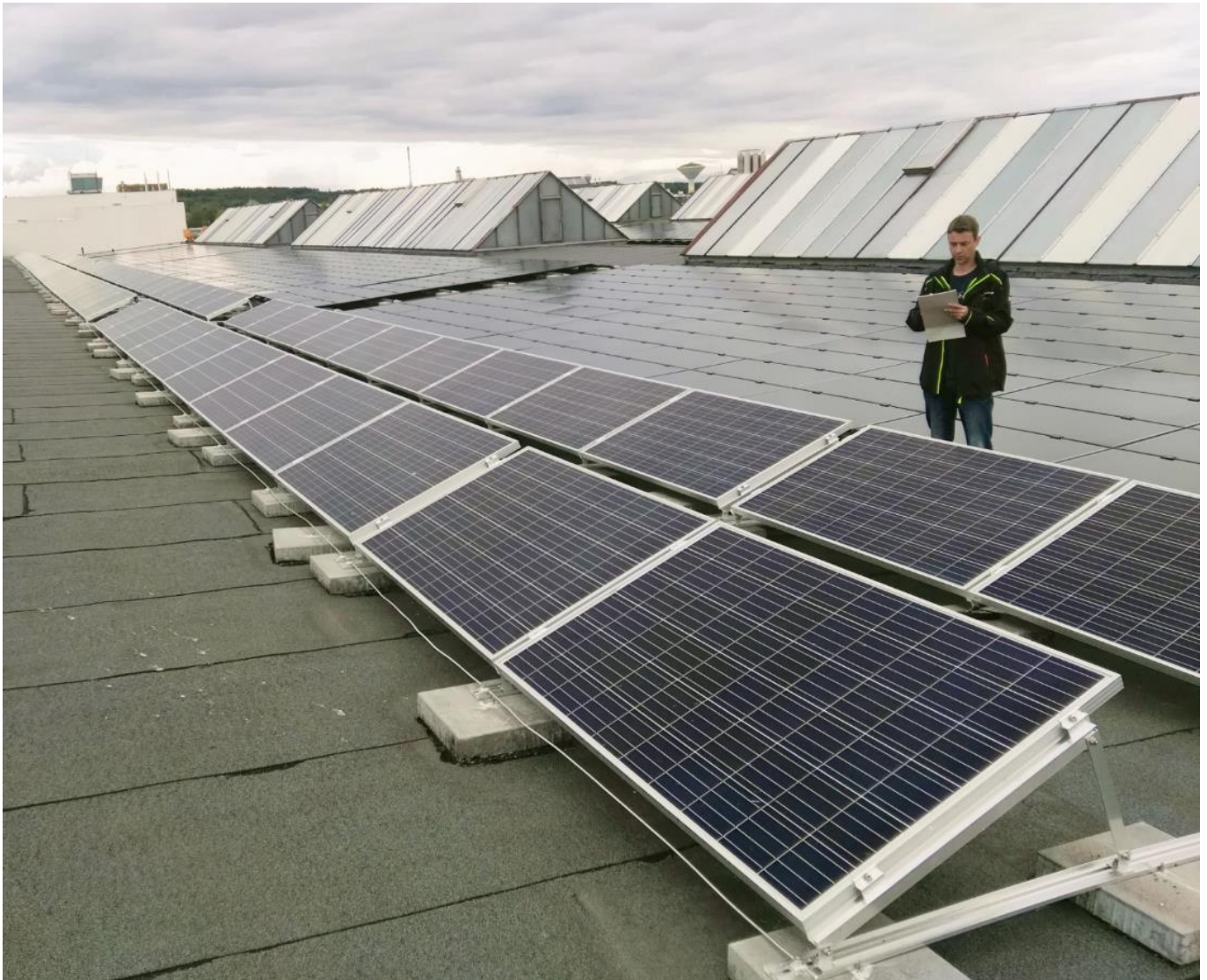
Bild: Abnahme der abgeschlossenen Repowering-Maßnahme am Standort Bobingen (Mai 2016)
